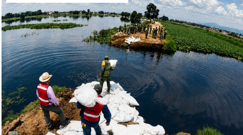
Fig. 1 Rotura el bordo Lerma en 2018. Fuente: Protección Civil de San Mateo.
