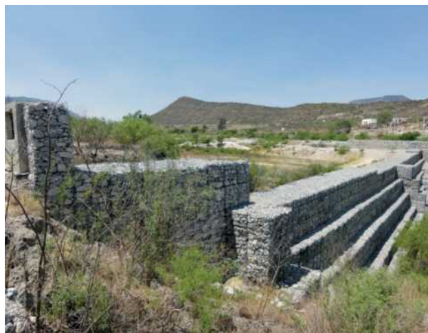
Figura 1. Vista general de la cortina desde la margen derecha; se aprecia la zona del vertedor, la caída escalonada y, al fondo, el dique de cierre del vaso.
