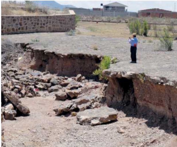
Figura 7. Erosión regresiva en el canal de descarga del vertedor de Los Burros.
