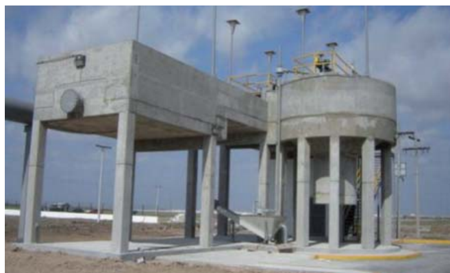
Figura 3. Estación de Bombeo No. 42.
