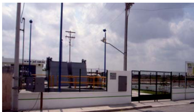
Figura 6. Estación de Bombeo No. 8.
