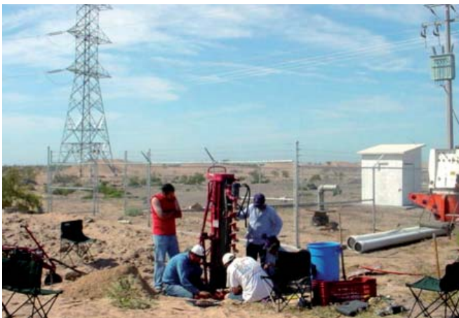
Figura 2. Perforación de pozos de observación por personal de la Universidad Autónoma de Baja California.
