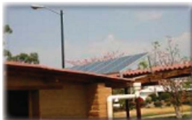
Captación y conducción de agua de lluvia.
