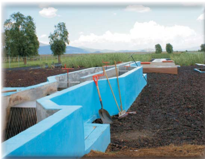
Humedal para el tratamiento de las aguas residuales de Erongarícuaro, Michoacán
