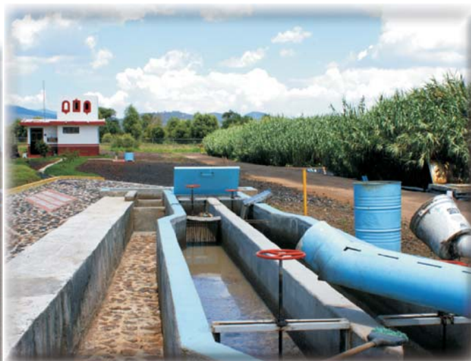
Humedal para el tratamiento de las aguas residuales en Santa Fe de la Laguna, Quiroga, Michoacán.
