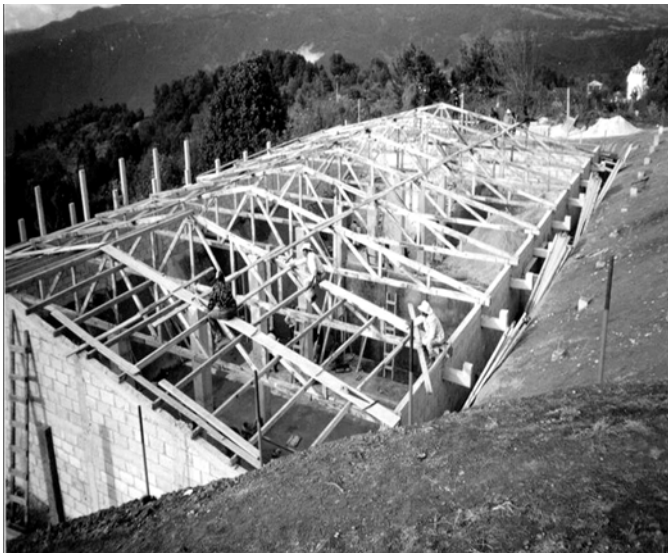
Fig. 1 Techumbre del colector de agua de lluvia (Mundo et al, 1997).
