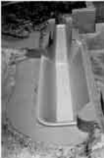
Foto 1. Vista total hacia aguas abajo del vertedor y canal de descarga. Se observa la forma en "L" del vertedor.
