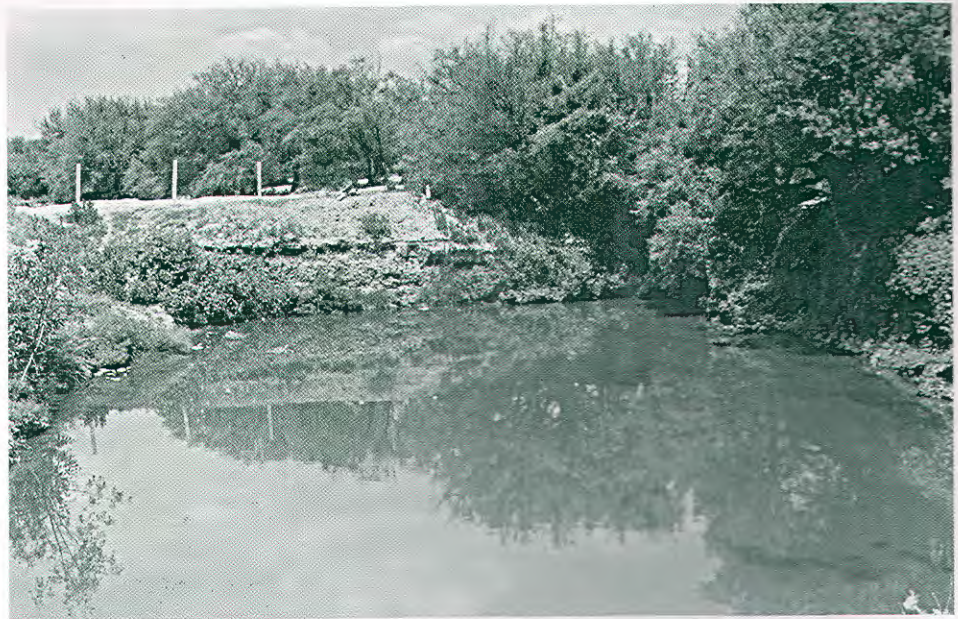
Figura 2. Erosión en el lado húmedo del bordo.
