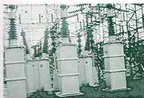
■ Estación de distribución de energía eléctrica Ixtapantongo.
