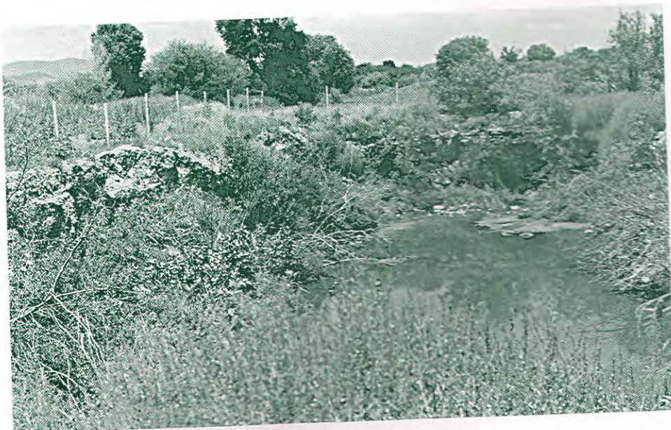
Figura 3. Detalle de la erosión del bordo en el lado húmedo.
