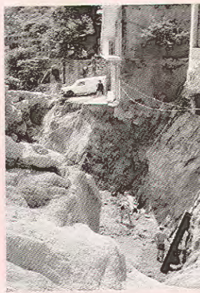
▲ FOTO 4. EROSIÓN OCURRIDA DURANTE LA INUNDACIÓN RELÁMPAGO QUE PRODUJO EL HURACÁN PAULINA EN ACAPULCO, EN 1997.
