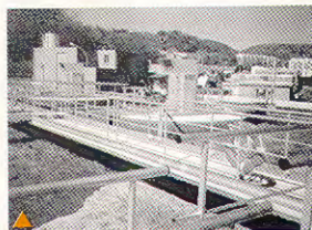
EQUIPO DE SEGURIDAD Y AUTOMATIZACIÓN EN UNA PLANTA DE AGUAS RESIDUALES DE LODOS ACTIVADOS (II-UNAM)
