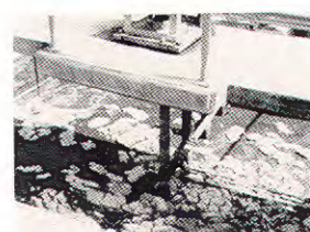
▲ CÁMARA DE COAGULACIÓN - FLOCULACIÓN FUERA DE OPERACIÓN (II-UNAM)
