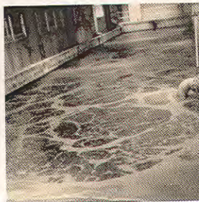
▲ PLANTA DE LODOS ACTIVADOS (II-UNAM)
