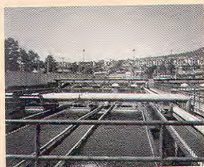
▲ PLANTA DE TRATAMIENTO DE CERRO DE LA ESTRELLA (DF), ZONA DE FILTROS (II-UNAM)
