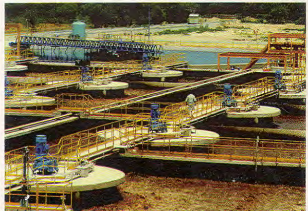
Servicios de Agua y Drenaje de Monterrey Planta de Tratamiento de Aguas Residuales Monterrey Noreste Monterrey, Nuevo León
