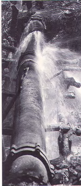
▲ FUGA EN LÍNEA PRINCIPAL ACAPULCO, GRO.
