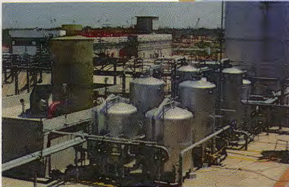
Tereftalatos Mexicanos Planta de Tratamiento y Desmineralización. Altamira, Tamaulipas.
