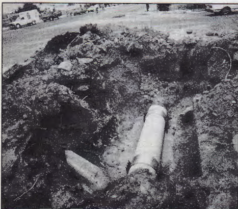
Fuga en la línea principal
